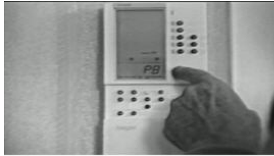
Figure 1.- Exemple de gestionnaire d'énergie. Les boutons en bas permettent la programmation du chauffage.
